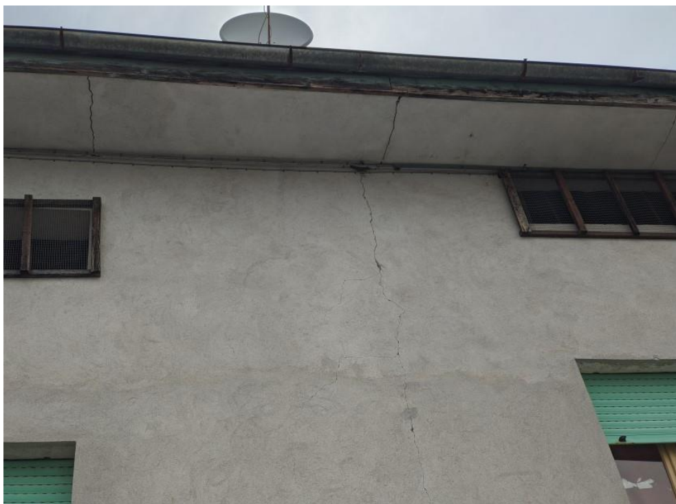
FOTO 35: FESSURE ESTERNE DEL FABBRICATO (Fronte strada)
