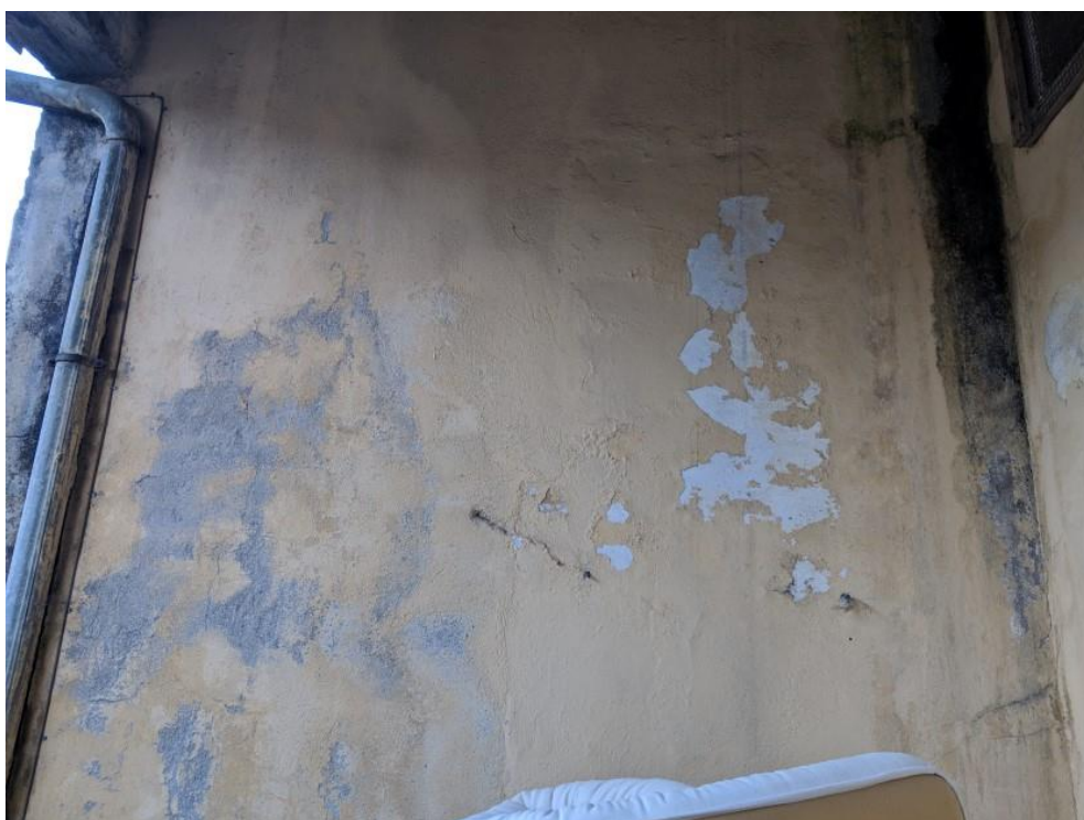
FOTO 36: SEGNI DI INFILTRAZIONE (Lato interno)
